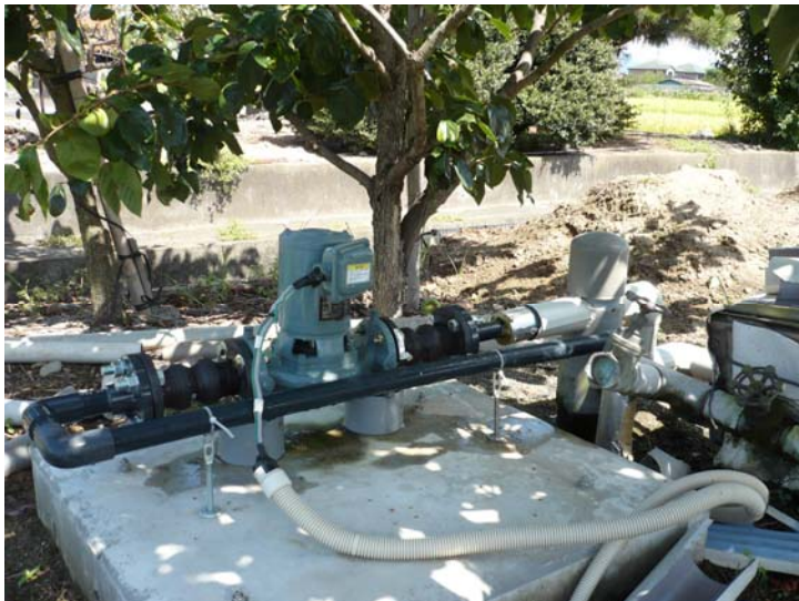
図 3-2 地下水の自噴井と循環ポンプ
